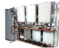
ラックシステム
