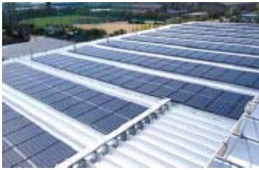
大成工業本社工場 (2011年10月設置、100kW)
