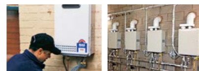
設置の様子 (オーストラリア) 設置事例 (イギリス)
