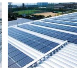
大成工業本社工場 (2011年10月設置、100kW)
