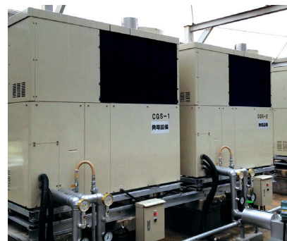
ガスコージェネシステム (NAM 本社工場)
