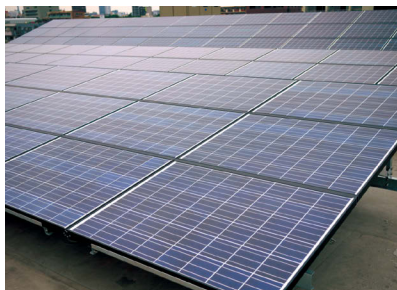
▲事務所屋上に設置している太陽光パネル
