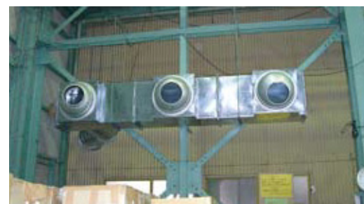
コンプレッサー排熱の暖房利用
