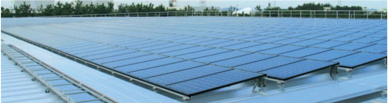
生産技術開発センター屋上の太陽光発電パネル
