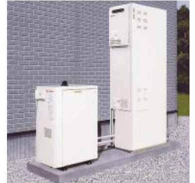
右が廃熱利用給湯暖房ユニット
