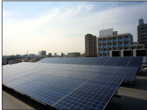
名古屋ショールームに設置した太陽光発電システム
