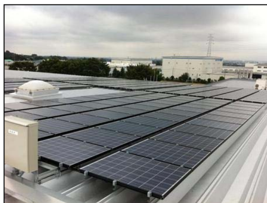
関東産業の屋根に設置している太陽光発電システム (2011年7月設置、50kW)
