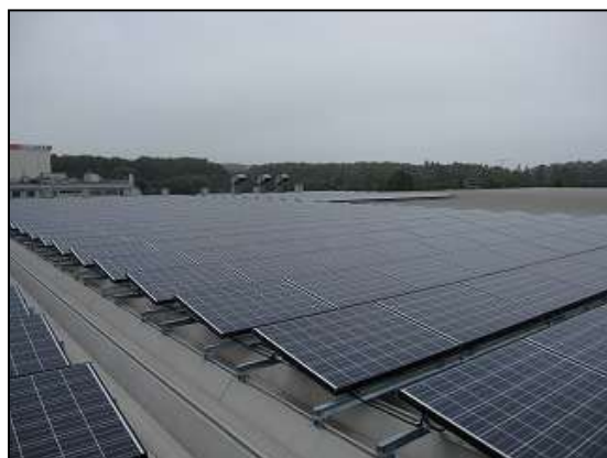
つくば工場の屋根に設置している太陽光発電システム (2011年8月設置、200kW)
