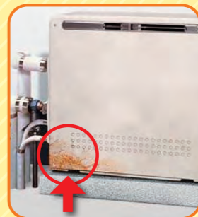
外装が錆で損傷
