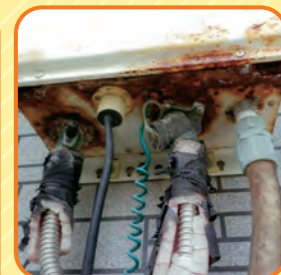
内部からの水漏れで外装が錆で損傷
